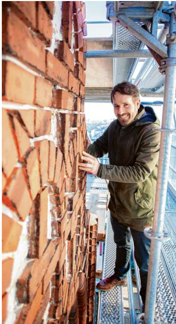
Hannes Mutschler (35) will Altes erhalten. Zurzeit arbeitet er am Turm der Martin-Luther-Kirche in Neukölln. FOTO: CHRISTIAN KIELMANN
